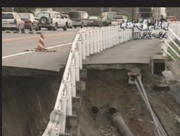
地中埋設管の寸断
